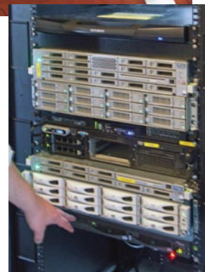
Umiejscowienie Kronosa w nowej serwerowni
