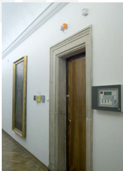
Wejście do jednego z magazynów (SSP, system gaszenia, SSWiN, SKD)
