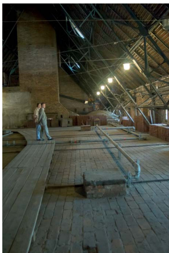
Strych – instalacja hydrauliczna systemu gaszeniowego
