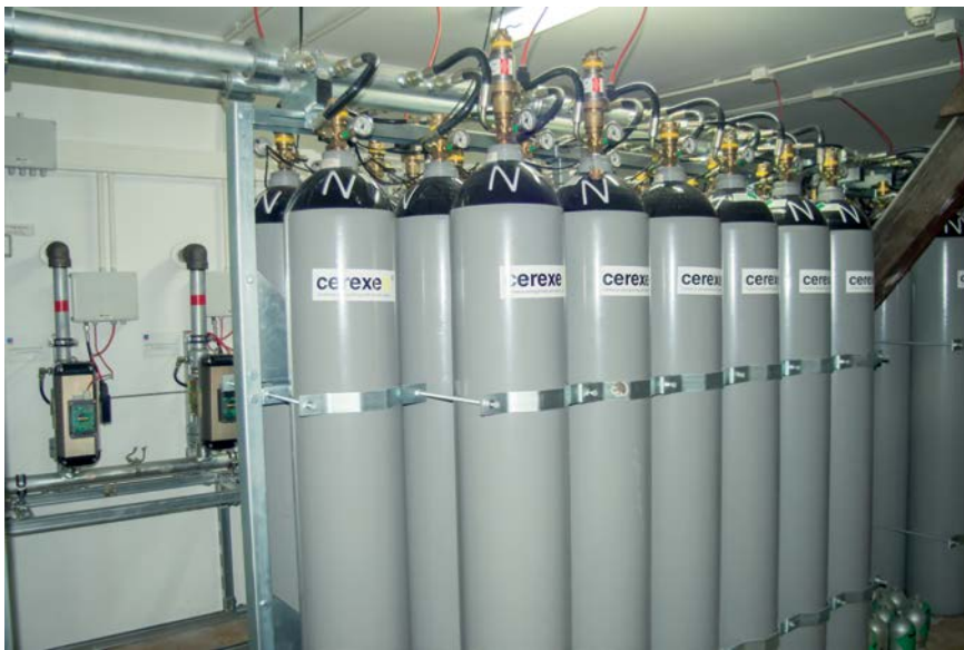
Wielostrefowe urządzenie gaśnicze z azotem – butlownia na strychu
