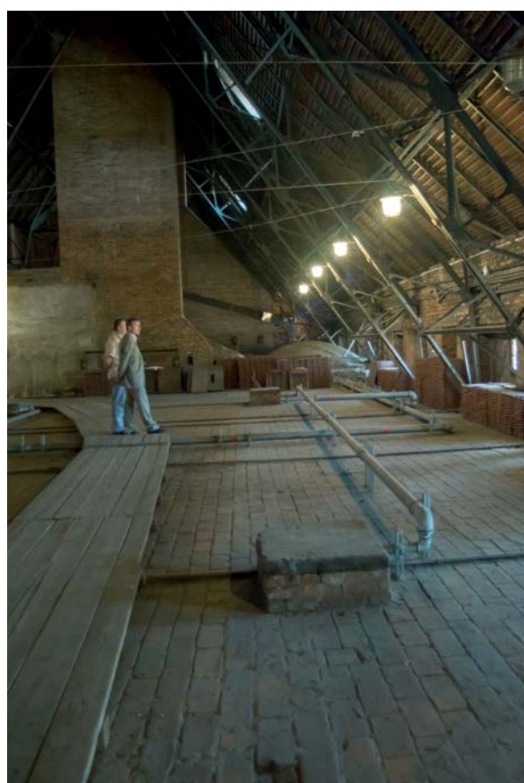
Strych – instalacja hydrauliczna systemu gaszeniowego
