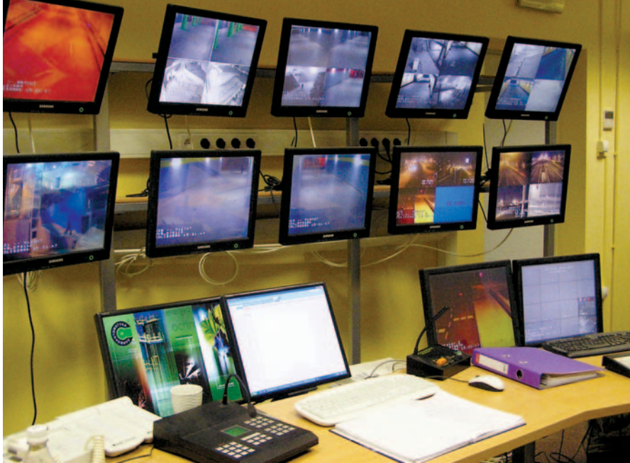
Fot. 2. Stanowisko operatora systemu CCTV wykonane zgodnie z zasadami ergonomii
