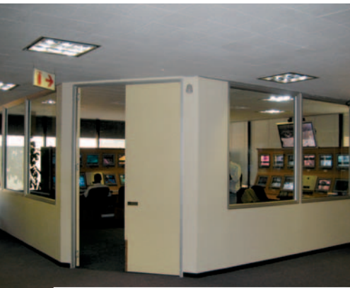
Fot. 3. Stanowisko zarządzania zdarzeniami – wydzielone pomieszczenie Centrum Nadzoru, w którym odbywają się operacje związane ze zdarzeniami zakwalifikowanymi do podjęcia interwencji.
