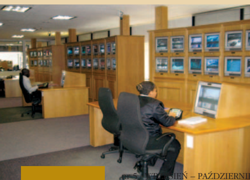
Fot. 1. Centrum nadzoru systemu CCTV w jednym z głównych miast RPA
