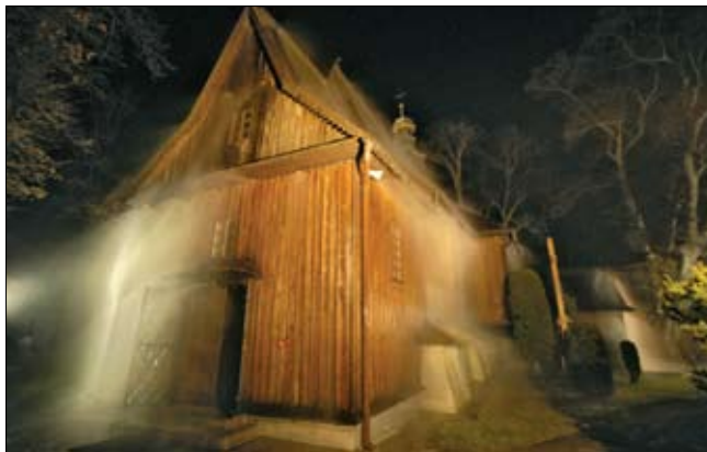
System gaszenia mgłą wodną FOG zainstalowany w drewnianym kościele w Modlnicy
